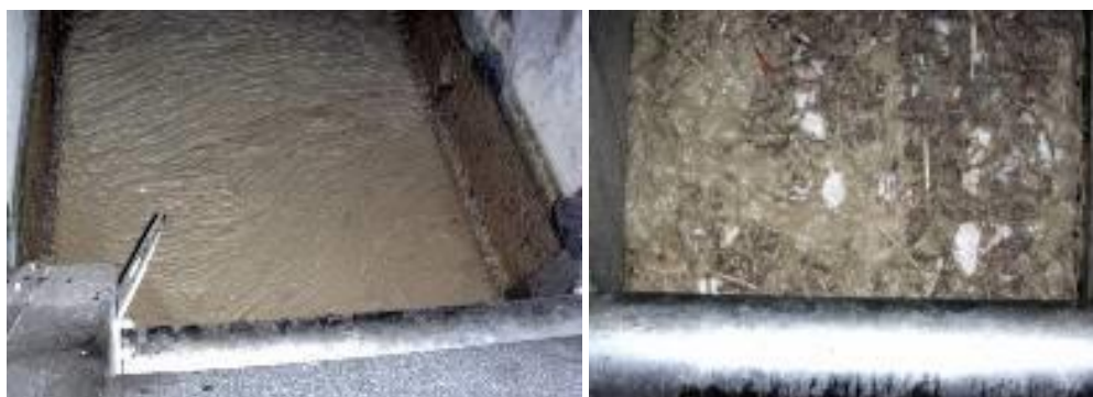
Rys. 3-4. Ścieki na kracie schodkowej
