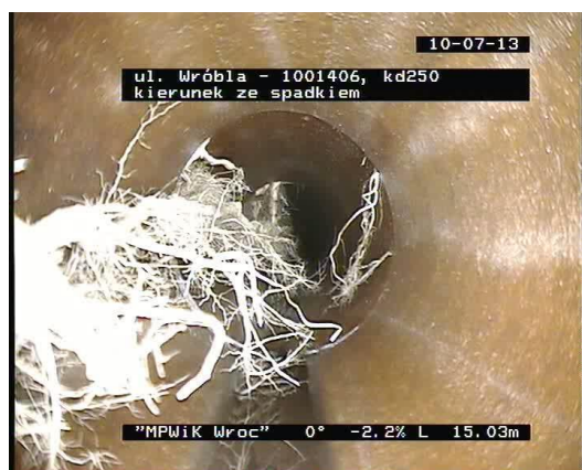
Rys. 8. Korzenie drzew wewnątrz kanału [13]
