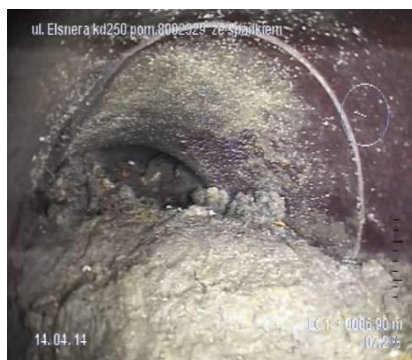
Fot. 2. Osady w przyłączy deszczowym
