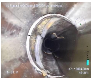
Fot. 4. Zapadnięcie stropu kanału przy jednoczesnym wysokim napełnieniu \varnothing 250 mm
