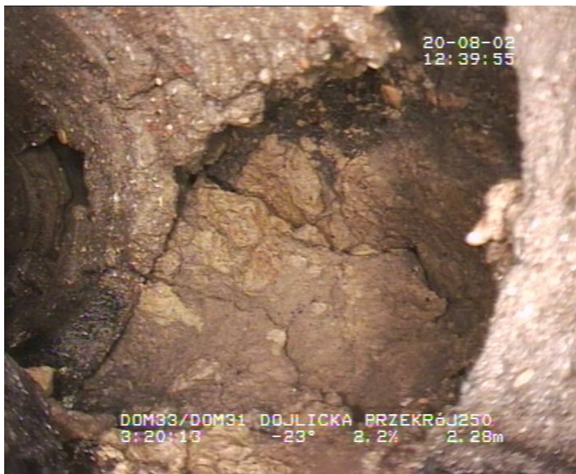
Fot. 9. Korozja rur betonowych w kanalizacji sanitarnej
