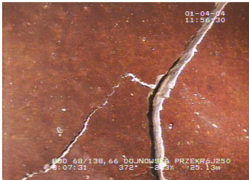
Fot. 6. Potencjalne miejsce awarii na kanale kamionkowym kanalizacji sanitarnej
