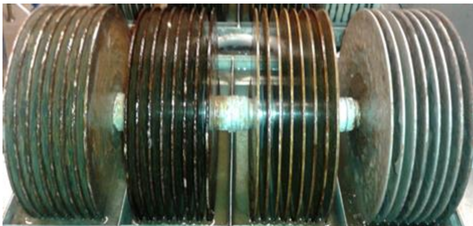
Rys. 1. Czterostopniowe biologiczne złoże obrotowe - od lewej kolejno 1, 2, 3, 4 stopień oczyszczania ścieków
