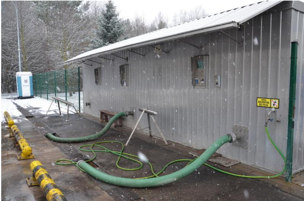
Rys. 2. Stacja zlewna przy białostockiej oczyszczalni ścieków
