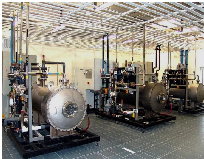
Rys. 1. Budynek ozonowania wstępnego SUW Pietrasze [13]
