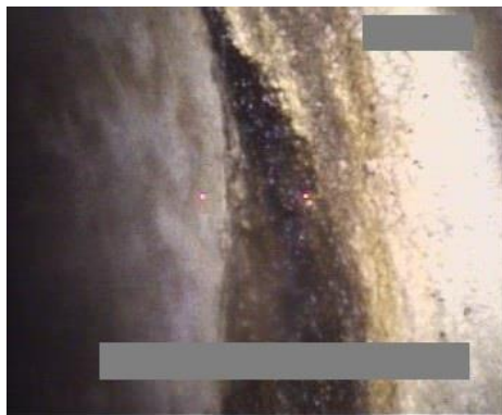
Rys. 4. Naciek na ścianie kanału spowodowany nieszczelnością
