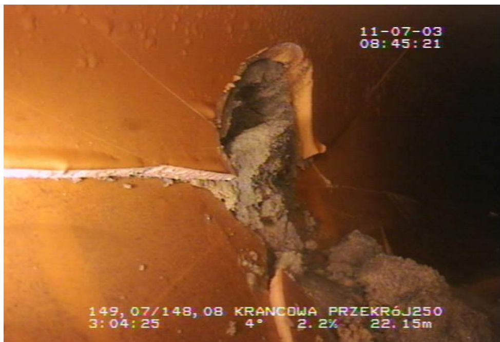
Rys. 10. Uszkodzenie rury PVC
