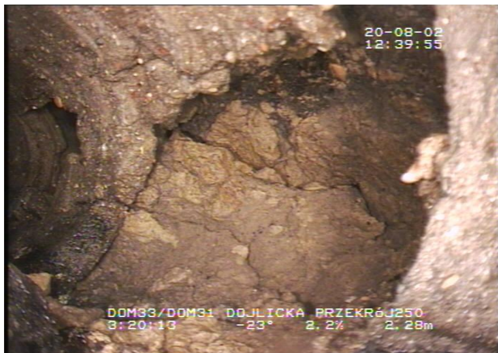
Rys. 3. Korozja ścian kanału betonowego
