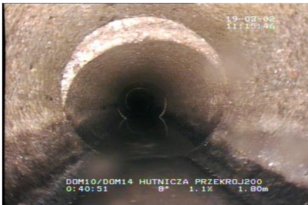
Rys. 2. Przesunięcia osiowe kanałów (tzw. klawiszowanie) jako miejsca awarii
