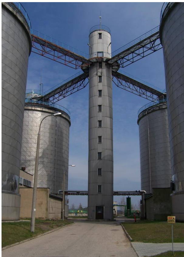
Rys. 1. Wydzielone komory fermentacyjne białostockiej oczyszczalni ścieków
