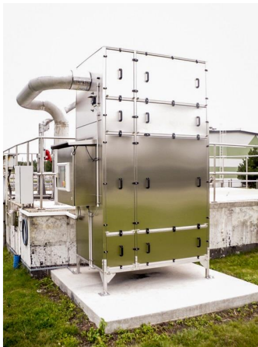
Rys. 3. Instalacja PCO dezodoryzująca gazy odlotowe emitowane w punkcie podnoszenia ścieków surowych (fot. T. Kielbasa)
